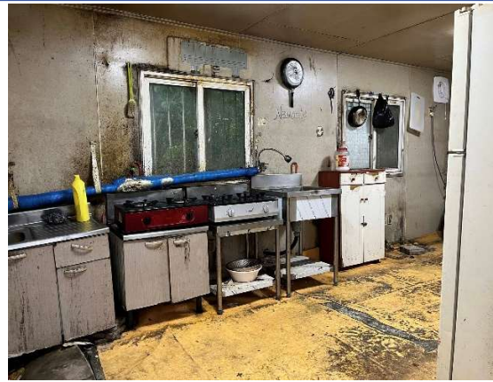
열악한 가설건축물 기숙사 내부 주방
