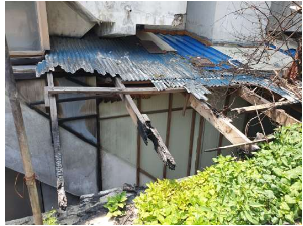
산불로 인한 주택 피해 흔적
