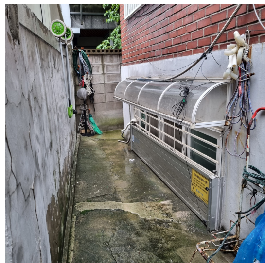
물막이판이 설치된 반지하주택
