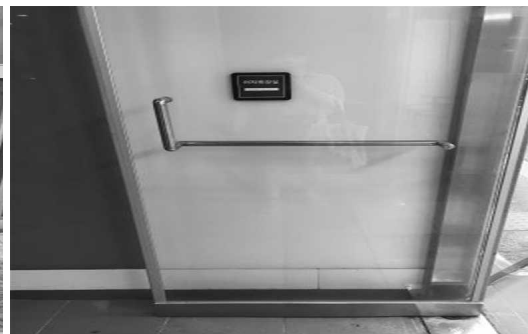
[그림 14] 일반화장실 옆 벽면 1.5m 높이가 맞지 않게 설치된 점자표지판, 설치되어 있으나 문 뒤에 가려져있어 실제 사용이 어려움
