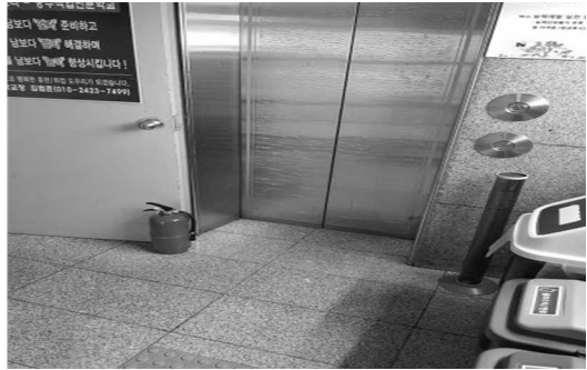
[그림 6] 전면간격이 맞지 않는 엘리베이터 전면 점형블록
