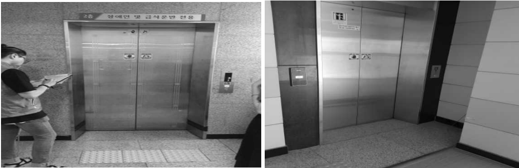
[그림 9, 10] 엘리베이터 호출버튼 전면에 설치되어 있지 않는 점형블록
