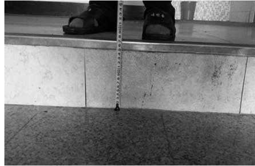
[그림 16] 출입구의 단차가 매우 높아 장애인 접근성이 낮은 화장실
