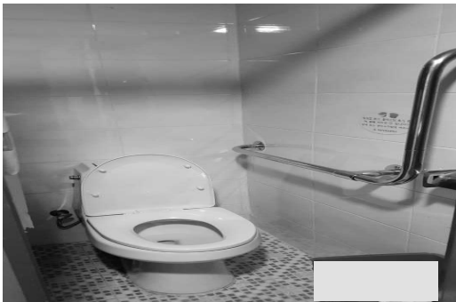
[그림 11] 회전식 손잡이가 미설치된 장애인용 화장실
