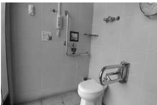
[그림 16] 휠체어 사용 장애인에게 높게 설치된 비상통화장치
