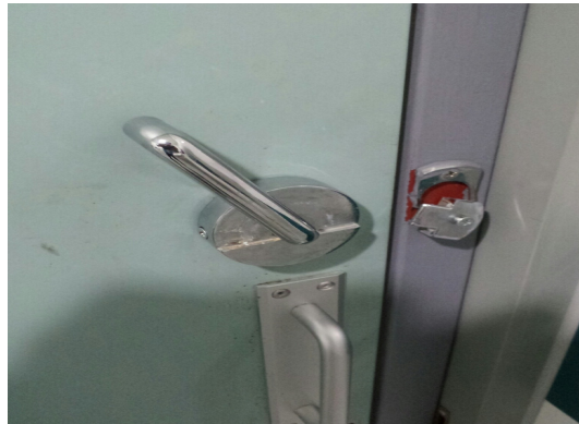
▲ 파손된 대변기칸 잠금장치
