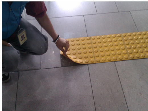
▲ 바닥에 완전히 고정되지 않고 일부가 떨어져 들린 상태의 점형블럭
