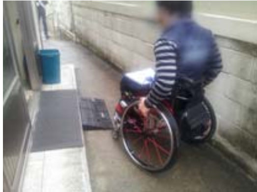
▲ 전면 유효거리 미확보 및 통과유효폭 미확보
