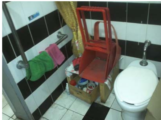
▲ 창고로 사용되는 장애인 전용 화장실
