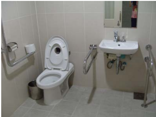
▲ 수직·수평 손잡이 설치된 장애인전용화장실
