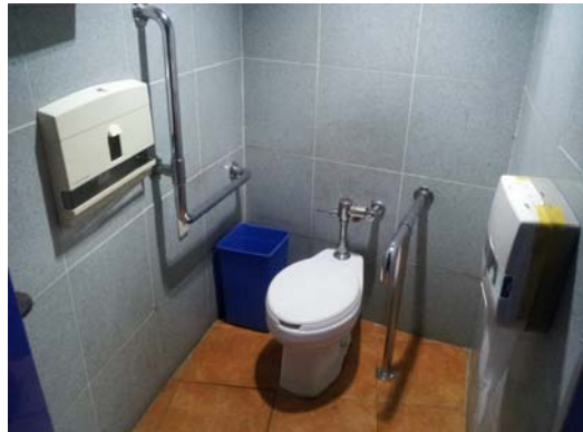
▲ 수직·수평 손잡이가 설치되었으나 좁은 화장실
