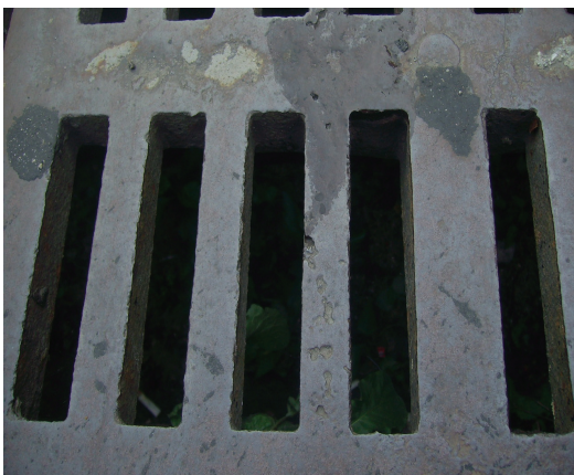
▲ 도서관 정문 앞 배수로 사이가 넓어 휠체어 바퀴가 빠질 우려 있음.
