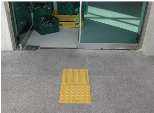
▲ 잘못 설치된 점자블럭.
