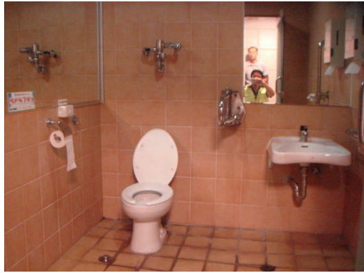
▲ 장애인화장실 대변기의 수평손잡이 및 수직손잡이 미설치
