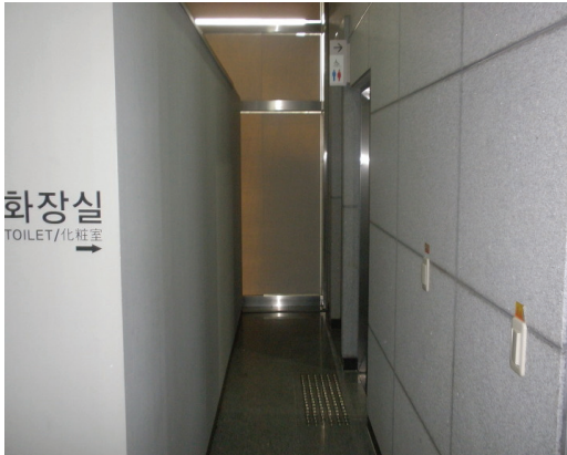
▲ 화장실 출입문 및 통로가 비좁아 휠체어 진입 어려움.
