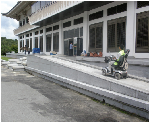
▲ 경사로의 난간이 설치돼 있지 않아 추락위험.
